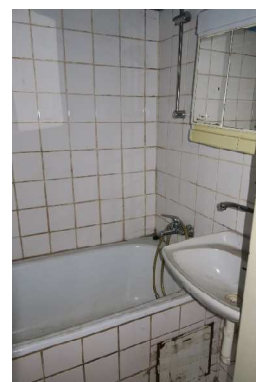
Koupelna domu č.p. 140
