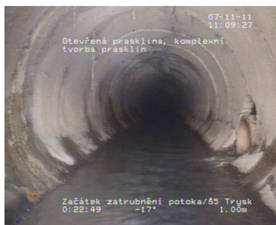
Příklad nevhodného zaústění potrubí
